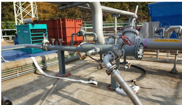
펌프 및 물탱크
