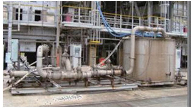
물탱크 및 펌프
